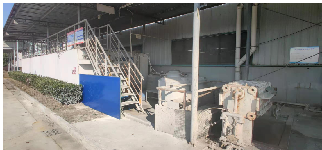
图 3-1 自建污水处理站
